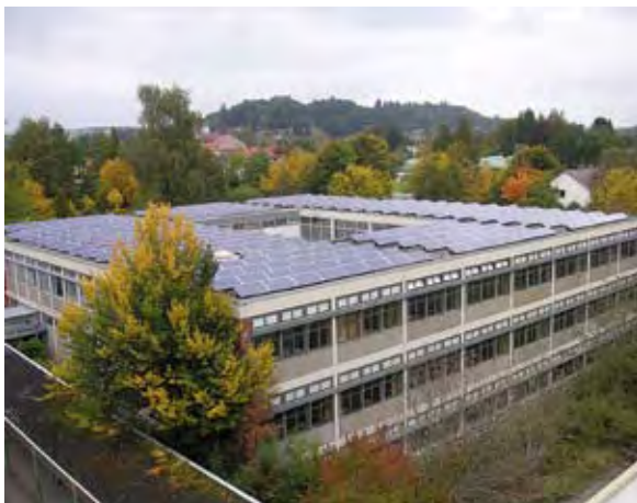
Leutkirhas skolas jumtu klāj Saules fotoelementu paneļi. Elektroenerģija tiek piegādāta pilsētas elektotīklam.
